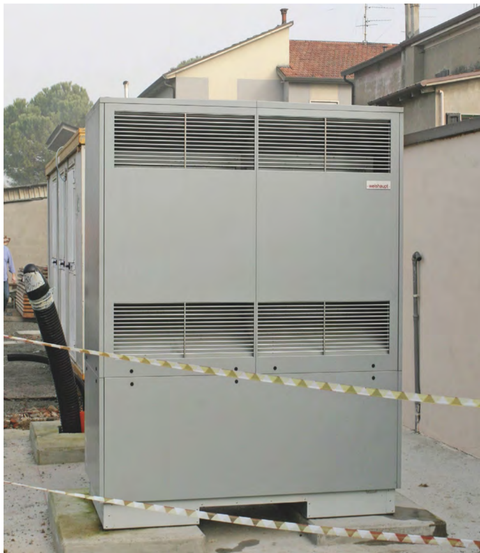
L'UNITÀ ESTERNA della pompa di calore è in esecuzione bi-compressore: produce acqua a 35÷30 °C, con 7 °C esterni, e a 7÷12 °C, con 35 °C esterni, oltre a fronteggiare il fabbisogno di ACS mediante recupero del calore di condensazione.
