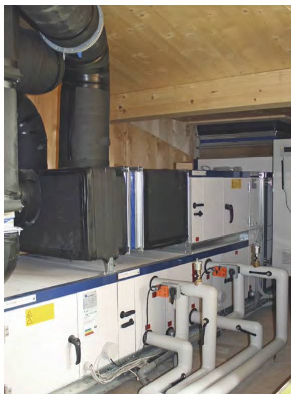
LE U.T.A. Una delle due unità di trattamento dell'aria (mandate pari a 2.000 e 2.500 m 3 /h), dotate fra l'altro di dispositivo per la deumidificazione e di recuperatore di calore in controcorrente sull'aria espulsa.
