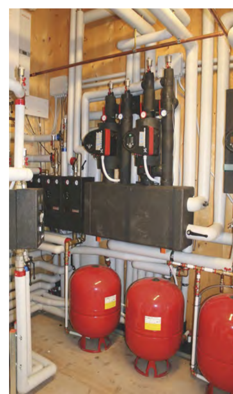
SOSTENIBILITÀ. CavaRei dispone di sistemi impiantistici di ultima generazione, a bassa temperatura e a minimo impatto ambientale, che viene ulteriormente contenuto dal campo fotovoltaico presente in copertura.
